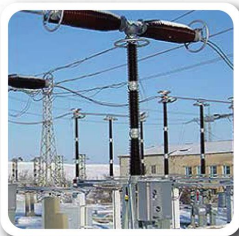
Int. de tanque vivo hasta 800 KV.
