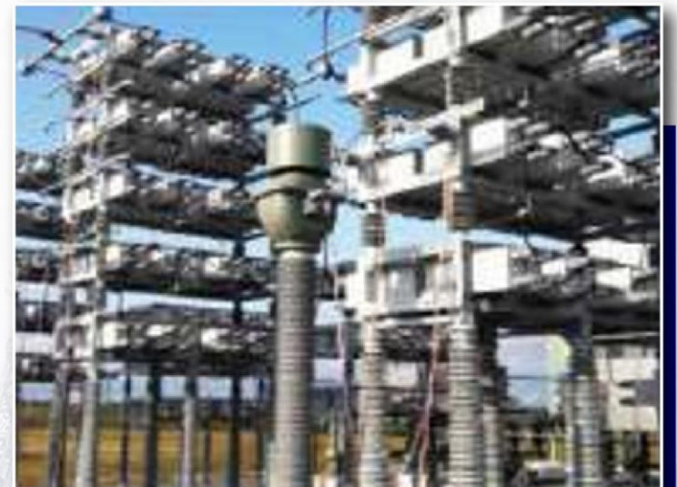
Banco de condensadores SHUNT con RACK
