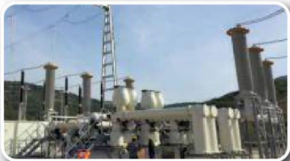
Subestación GIS T155 hasta 420 KV. 65 KA y 5000 A
