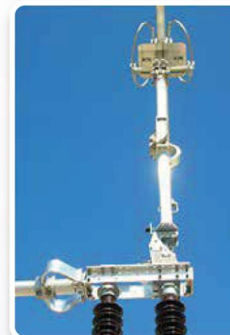
Seccionador Semi-pantógrafo SPV hasta 1000 kV.
