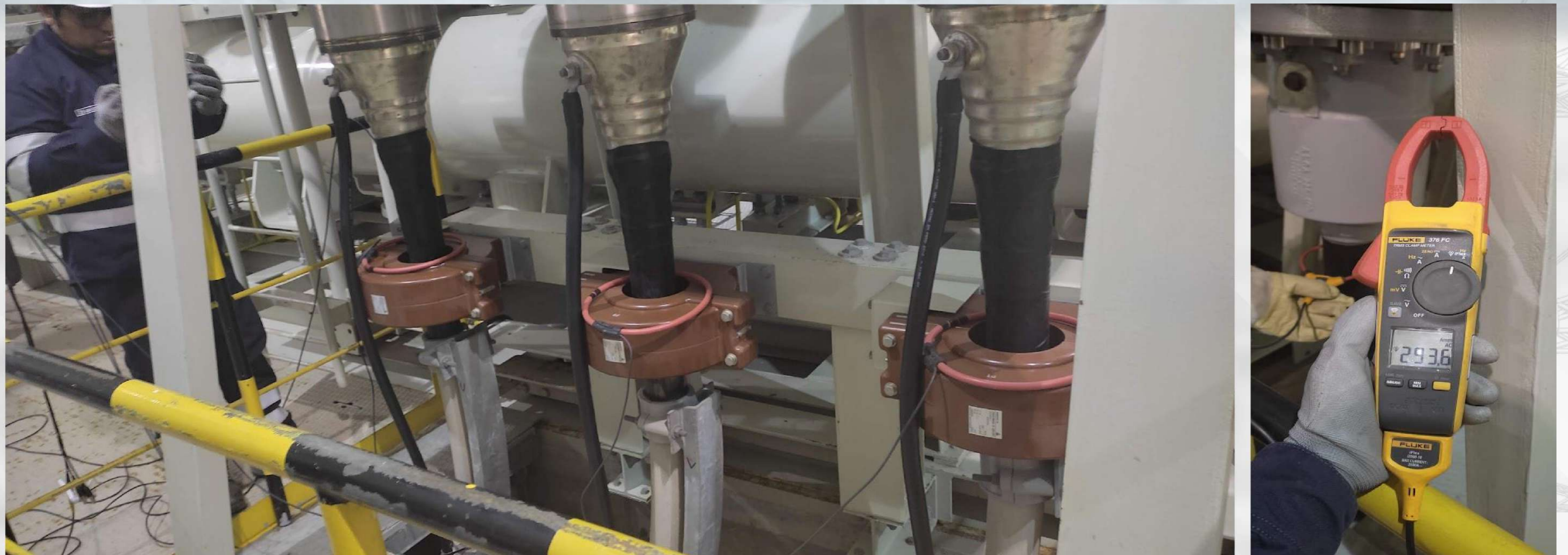
Terminación de GIS: Cable de 220kV XLPE
